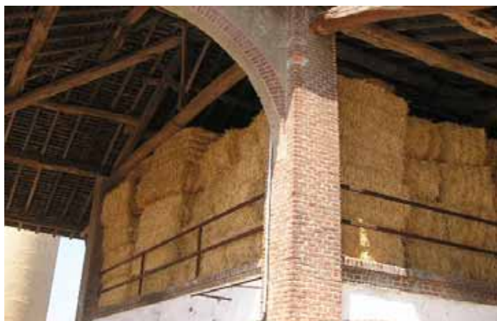
Figura 1 – Nei fienili i rischi più frequenti sono dovuti a sovraccarico del solaio e ribaltamento delle balle.
