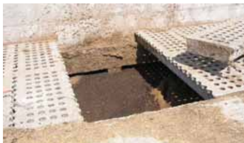
Figura 2 – Settore di pavimento fessurato spostato per consentire il pompaggio del liquame.
