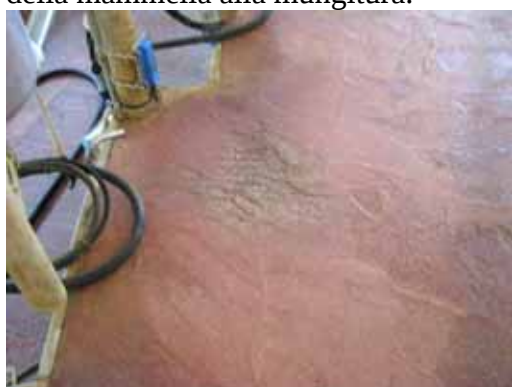
Figura 21 – Pavimento in battuto di cemento antiscivolo, parzialmente corrosivo in corrispondenza dell'attacco del gruppo di mungitura.
