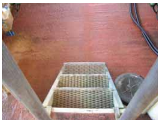
Figura 22 – Scala di accesso alla buca di mungitura senza protezioni laterali.
