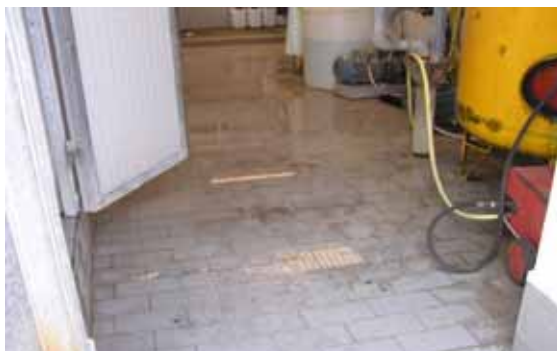
Figura 1 – Insufficiente drenaggio causa pericolosi ristagni d’acqua.
